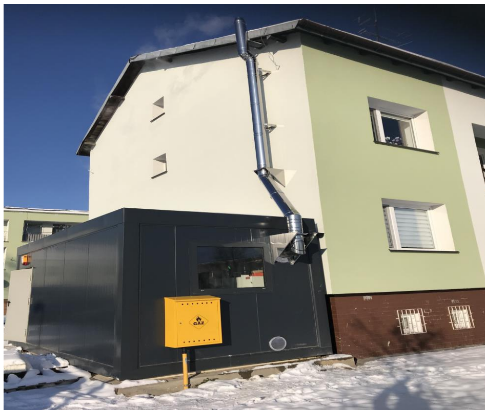
Kotłownia Gazowa przy budynku mieszkalnym nr 4
